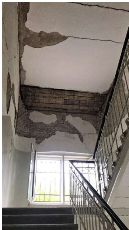
Oštećenja zavodskih stuba
