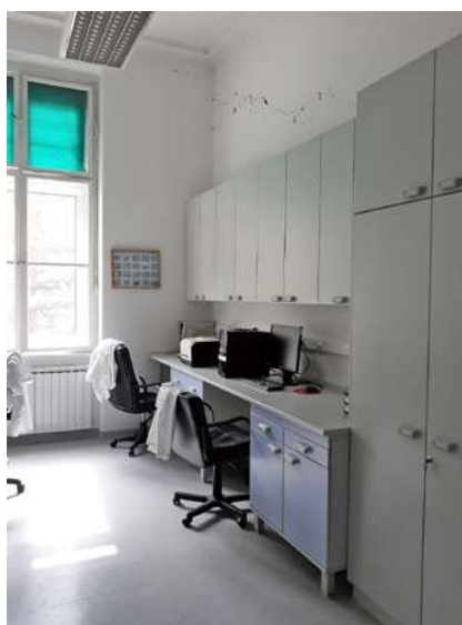
Kosa pukotina u vanjskom zidu Zavoda zbog koje ovaj laboratorij Zavoda nije upotrebljiv
