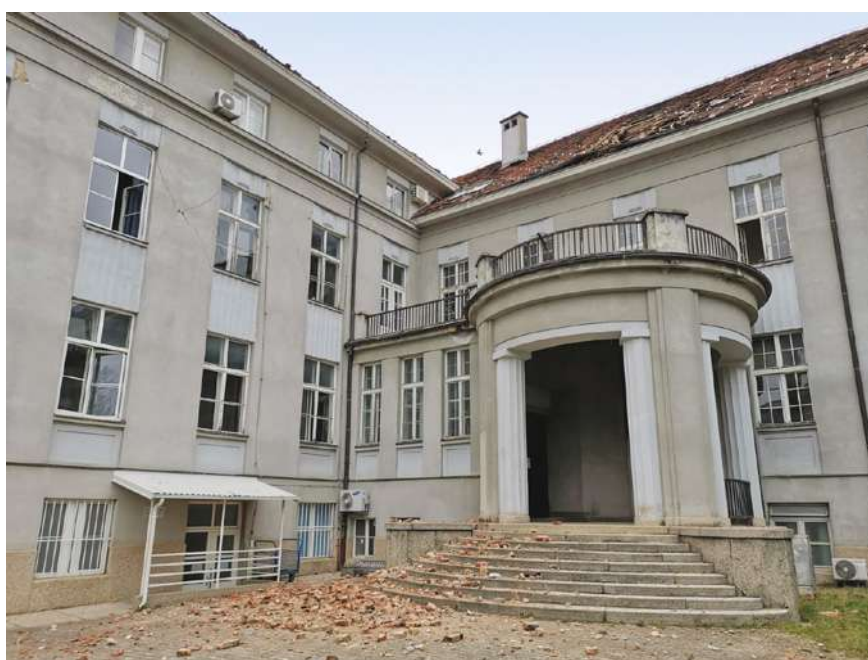
Križne pukotine ispod EM centra
