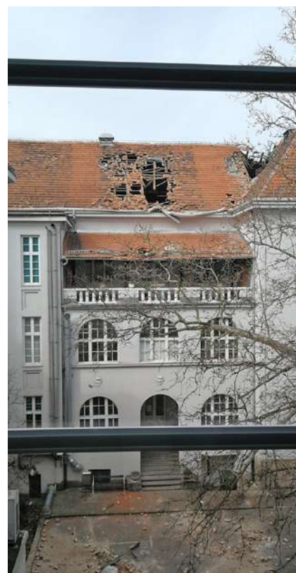
Slika oštećenja krila zgrade gdje se nalazi Zavod za histologiju i embriologiju
