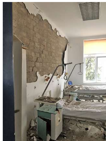
Znatna strukturalna oštećenja zidova na Odjelu jednodnevne kirurgije Klinike za ortopediju
