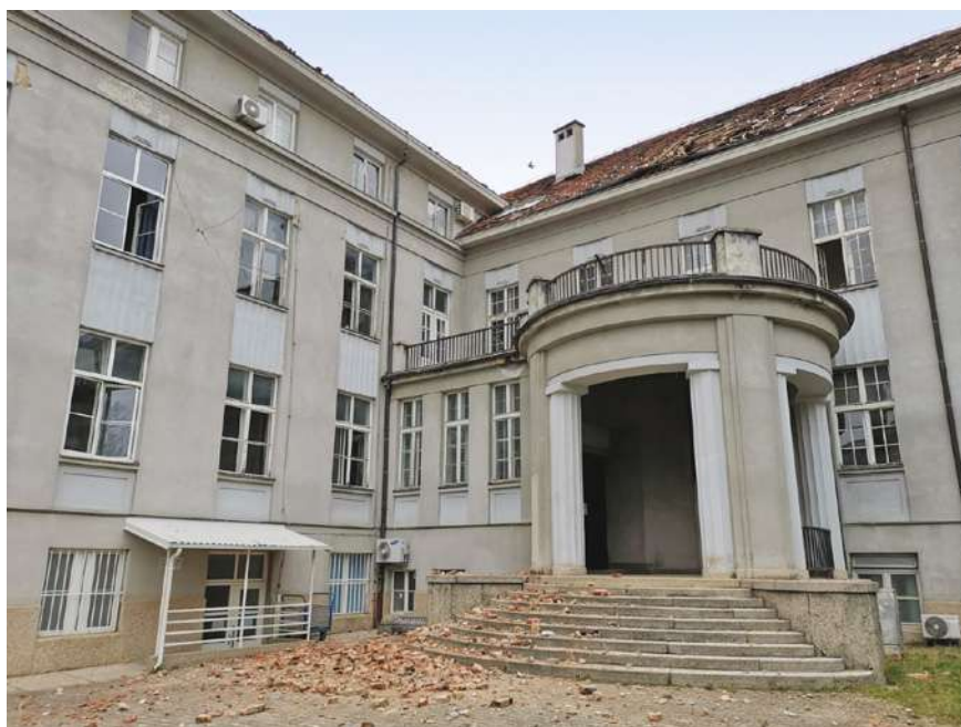
Križne pukotine ispod EM centra
