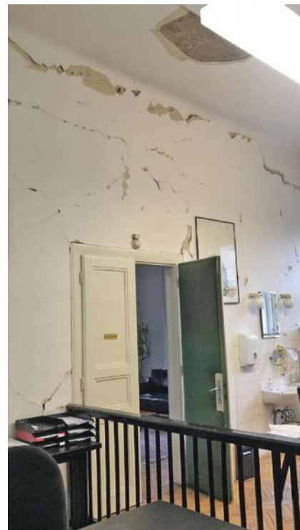
Ured Zavoda nakon potresa
