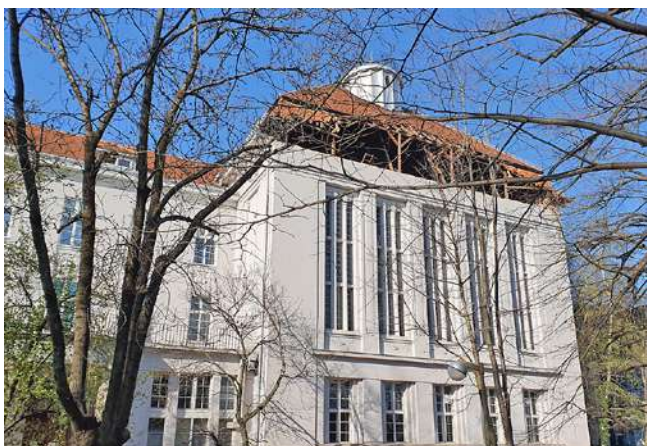
Zgrada starog dekanata sa znatnim oštećenjem krova
