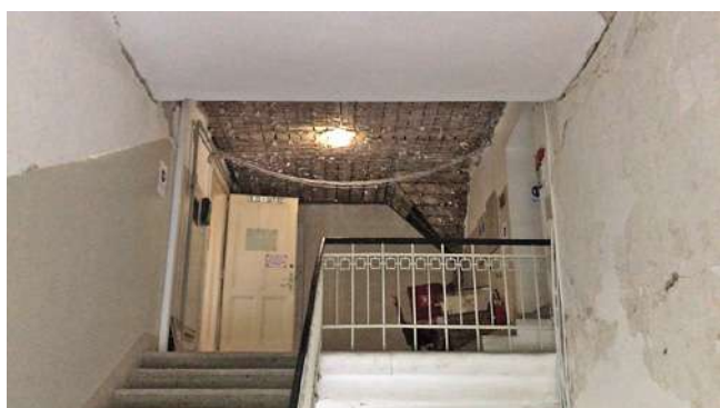
Ulaz u laboratorije (slika lijevo) i detalj oštećenja u knjižnici Zavoda
